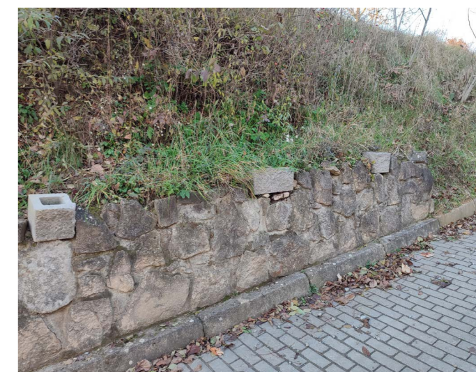
| Vizuální degradace místa nevhodným použitím a umístěním různých prvků (např. betonové tvarovky)
